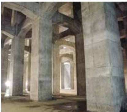
善福寺川調節池(地下箱式)
