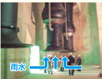
神谷ポンプ所(北区)
